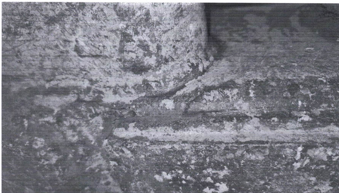
Detalhe de trinca na estrutura da concha.
